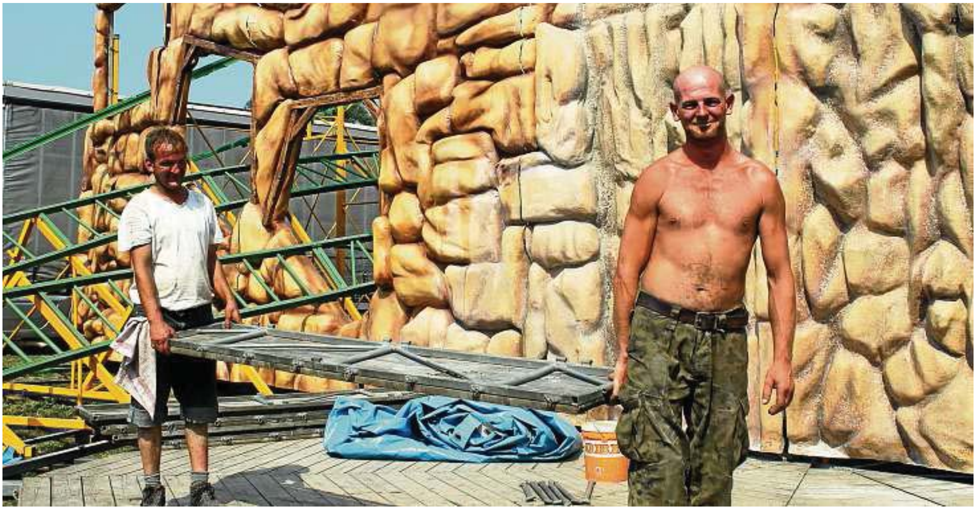
Vor der Felswand der Familienachterbahn „High Explosive“ tragen Mitarbeiter Holzbohlen für den Belag. Seit Anfang der Woche wird das Fahrgeschäft aufgebaut.
