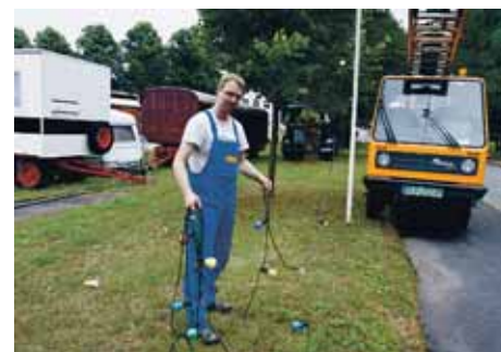
Ohne die Elektriker bliebe der Festplatz sprichwörtlich im Dunkeln.
