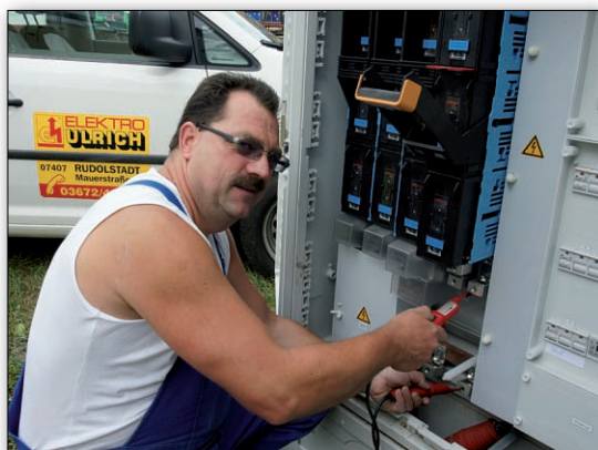
Elektriker Frank Engelmann bei der Überprüfung eines Anschlusschranks. Foto: Abendroth
